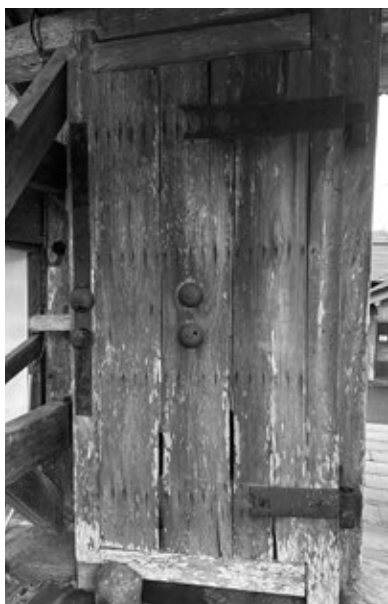
本坊表門 解体前（金具破損）
